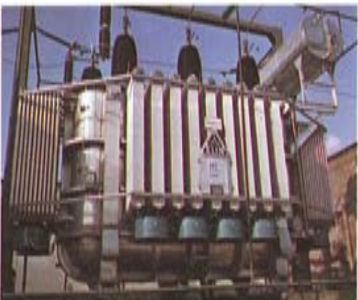
6 Trefasetransformator 110 kV/20 kV
